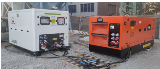
Equipos de generación eléctrica en el emplazamiento de pruebas
